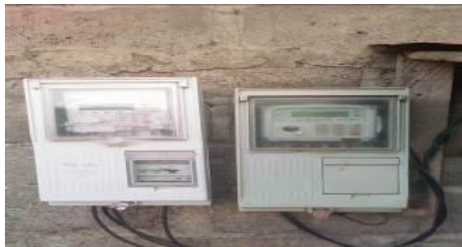
Figure 2. Compteurs d'électricité placés par la CEET (Source : travaux de terrain, novembre 2025).
