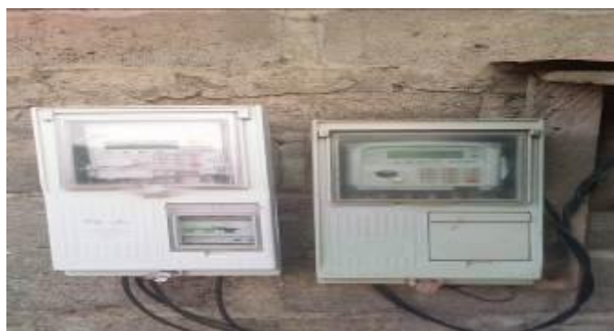
Figure 2. Compteurs d'électricité placés par la CEET (Source : travaux de terrain, novembre 2025).
