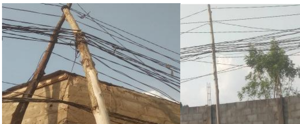
Figure 5. Branchement en toile d'araignée à Davié-Tékpo (Source : travaux de terrain, novembre 2025).
