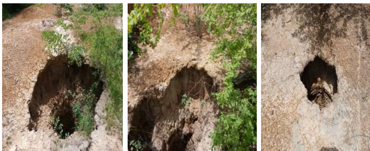
Figure 1. Site de Kofré fermé depuis 2019 illustrant l’absence de stratégies pour la réhabilitation des sites après leur épuisement (Source : Konan, 2025)
